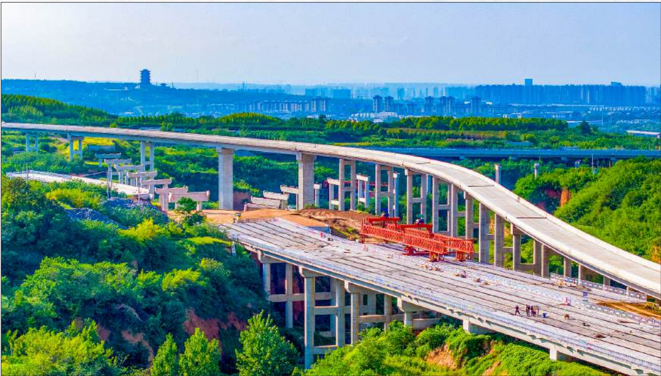
Pamje e vendit të ndërtimit të projektit të Autostradës Zhengzhou-LuoYang, në qytetin Luoyang, Provinca Henan e Kinës, shtator 2025. / Foto nga VCG
